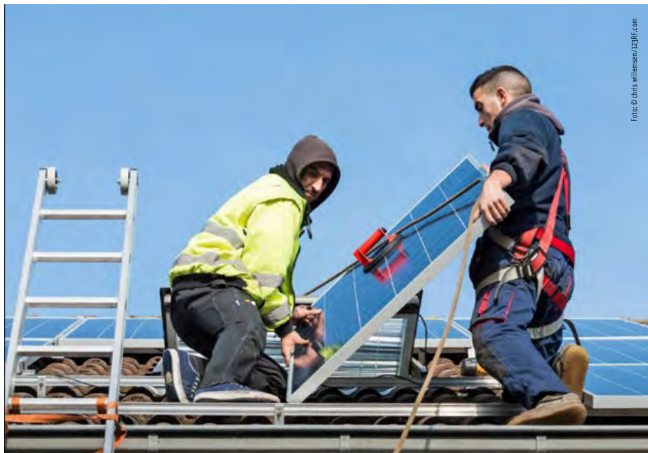
Photovoltaik, Solarthermie, Wärmepumpe und moderne Gebäudetechnik wachsen in der Praxis immer stärker zusammen.
