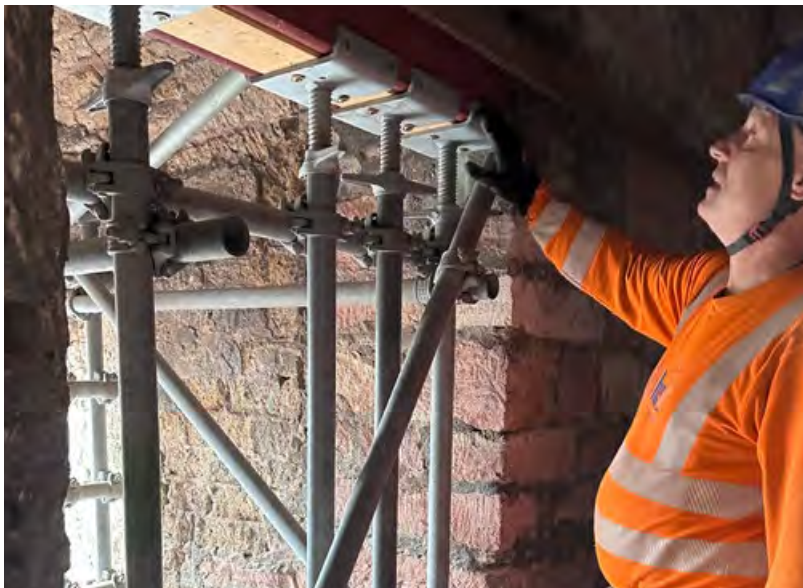
Vorarbeiter Guido Raab von Hecht Gerüstbau zeigt, dass das Gerüst hängt und nicht verschraubt ist.
